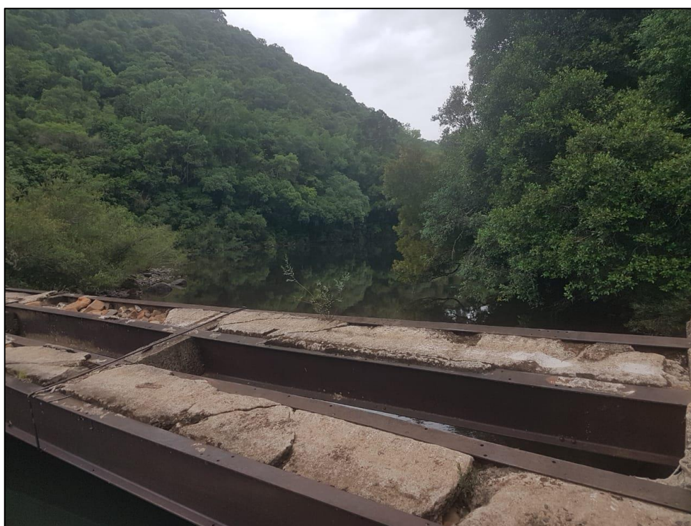
Figura 12 – Estado de conservação da ponte atual.
